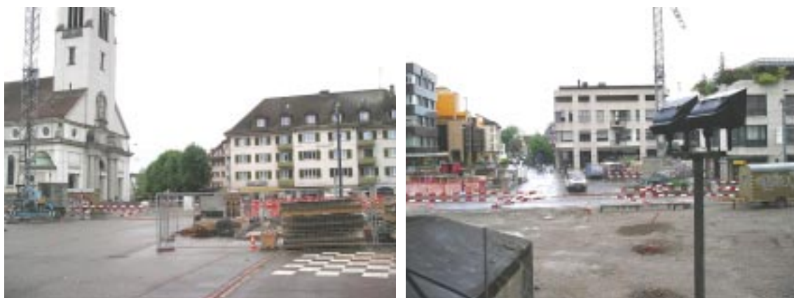
Im Frühjahr 2005 gaben sich Baukräne, Bagger und Bulldozer auf dem Dietiker Kirchplatz noch ein Stelldichein, doch schon bald sollen hier diverse Veranstaltungen das Zentrum neu beleben (Bilder: RZU).
